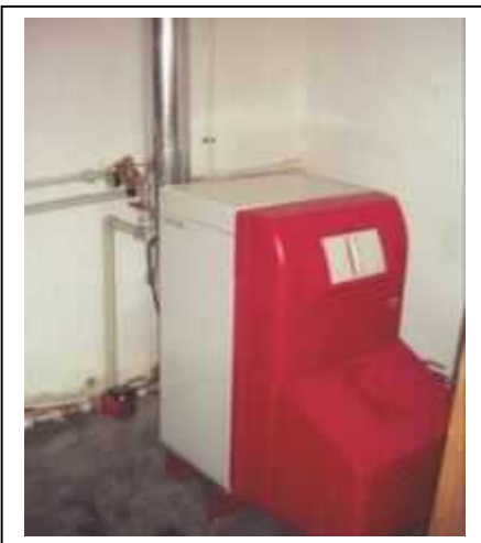
Unsere neue Heizung.
