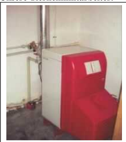
Unsere neue Heizung.
